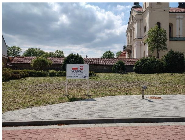
Zdjęcie 20 Zabezpieczenie przeciwpożarowe wykonane w Klasztorze OO. Bernardynów w Kalwarii Zebrzydowskiej
